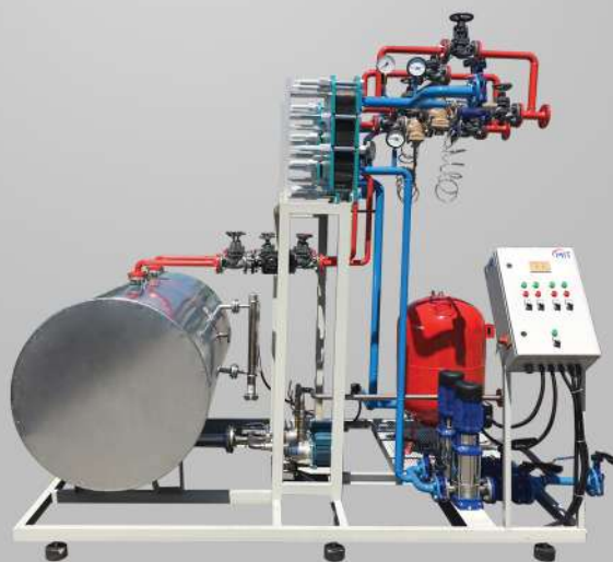
ИНДИВИДУАЛЬНЫЙ ТЕПЛОВОЙ ПУНКТ
